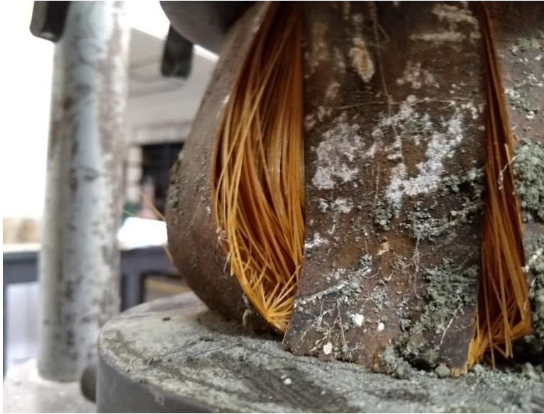
Anexo 9. Ausencia de rigidez debido a la pérdida de la matriz conglomerante de fibras.
