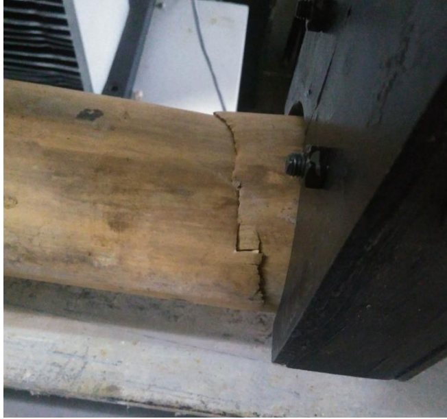
Anexo 5. Falla por aplastamiento en ensayo a flexión (inválido).
