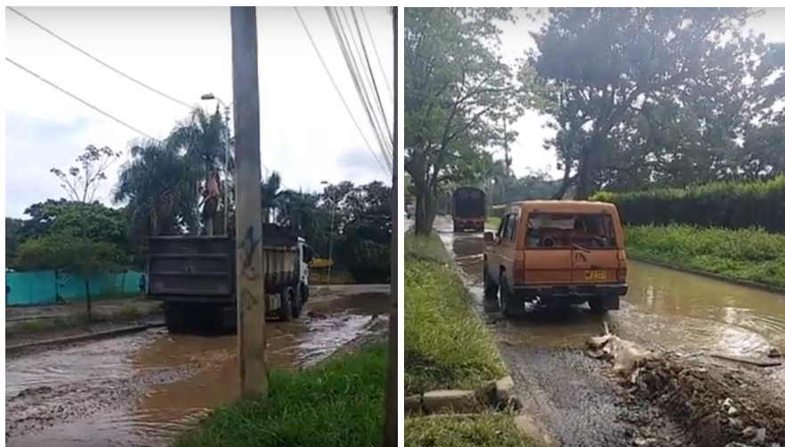
Figura 8. Deterioro en vía de acceso de carga en Jamundí. 2017
