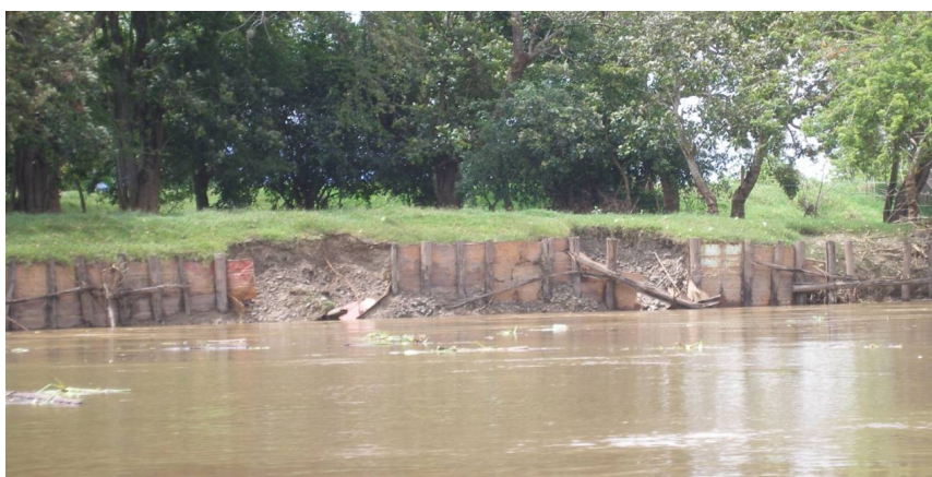
Foto 3.1 Protección con pilotes de madera y canecas
