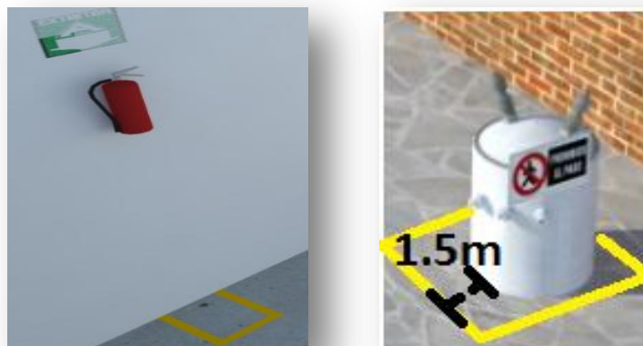
Figura 16. Ubicación del extintor de fuego y distancia máxima de acercamiento al transformador.
