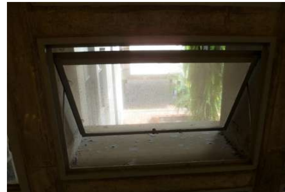
El polvo y el deterioro han opacado la transparencia de la luz natural que puede aportar al interior de la edificación.
