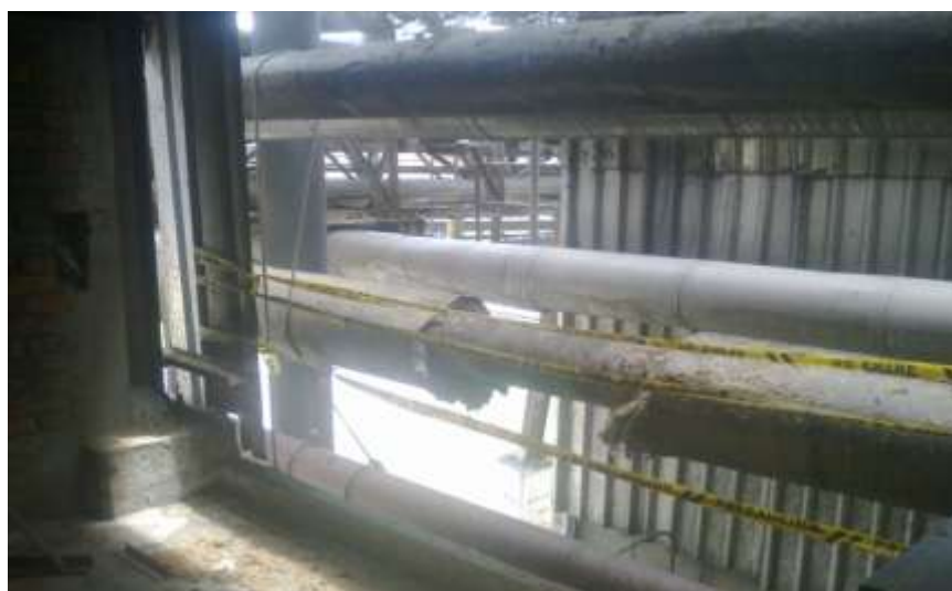
Figura 22. Mantenimiento estructural. (Ausencia de guardas de seguridad).
