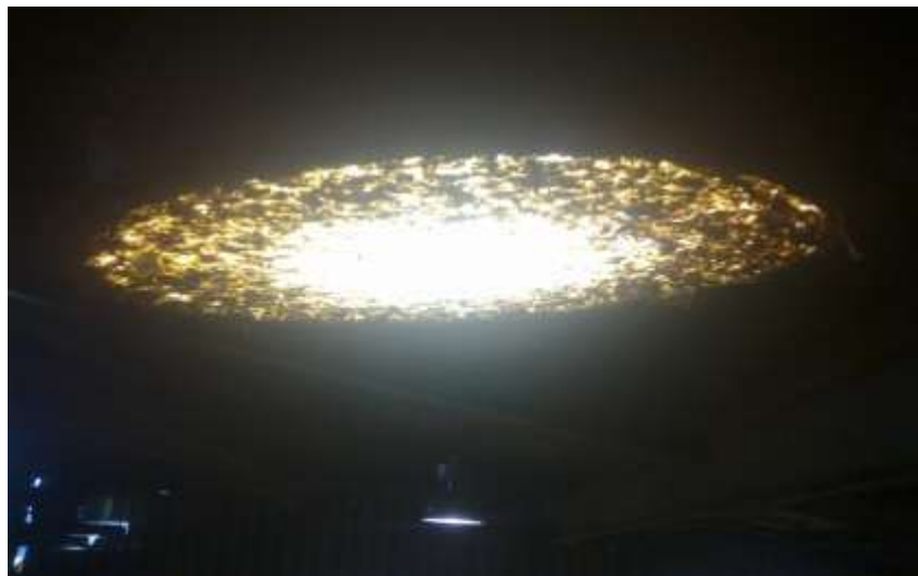
Figura 21. Deficiencia en mantenimiento de lámparas
