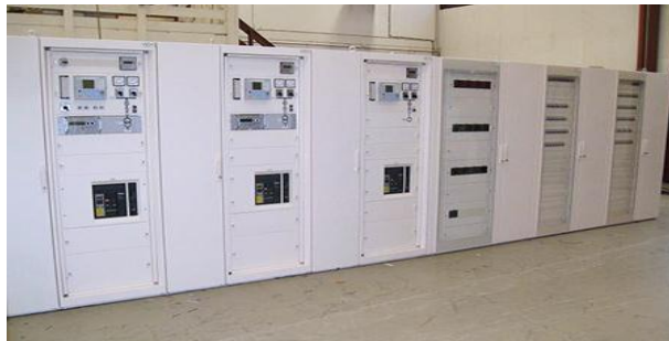
Figura 4. Tablero de baja tensión con interruptores y equipos de protección y medida
