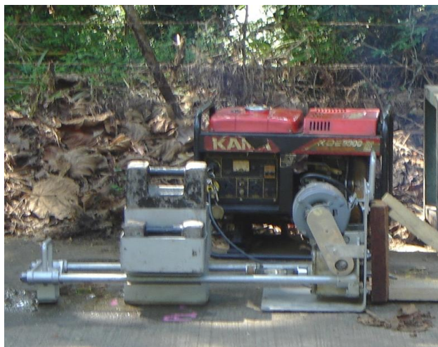
Fotografía 12. Funcionamiento planta eléctrica
