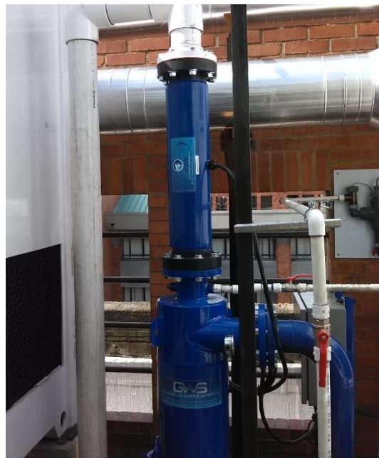
Ilustración 31. Planta de tratamiento de agua.
