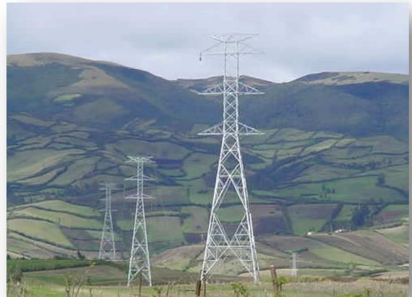
Foto 7: Expansión de la interconexión
