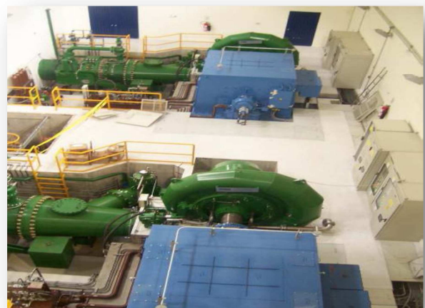
Foto 5: Turbinas Central Amaime
