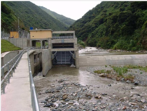
Foto 2: Bocatoma Central Amaime
