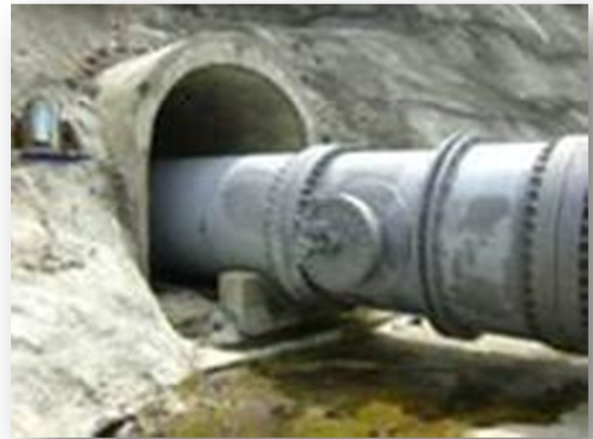
Foto 3: Tubería de conducción Central Amaime
