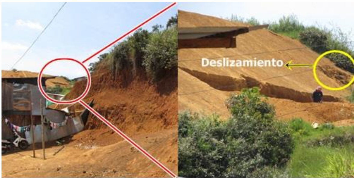
Figura 31. Formas inadecuadas de terraceo para la construcción en el sector de Provivienda la Magdalena
