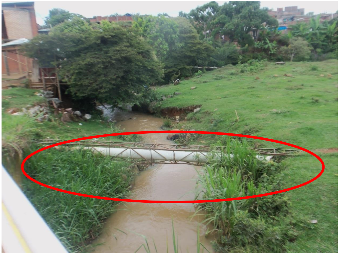
Figura 70. Tubería de agua Fuente: Ceidy Castillo y Nisley Zúñiga
