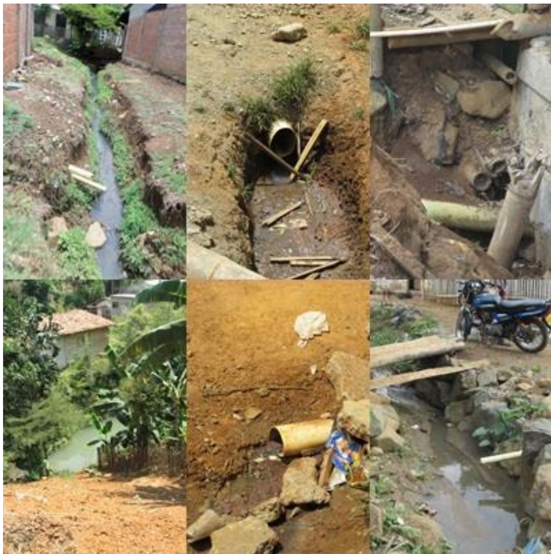
Figura 21. Alcantarillado rudimentario en los sectores de las Colonias y Fundación Provivienda la Magdalena.
