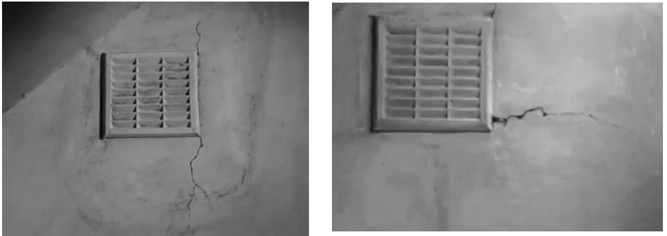
Imagen 10: Las grietas cambian de dirección
