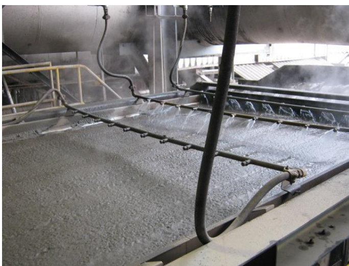
Figura No.9. Filtro Banda.
