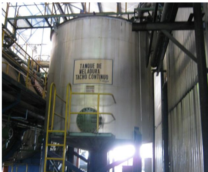
Figura No.13. Tanque de Meladura.
