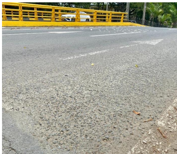
Figura 11. Rugosidad en la superficie de rodadura.
