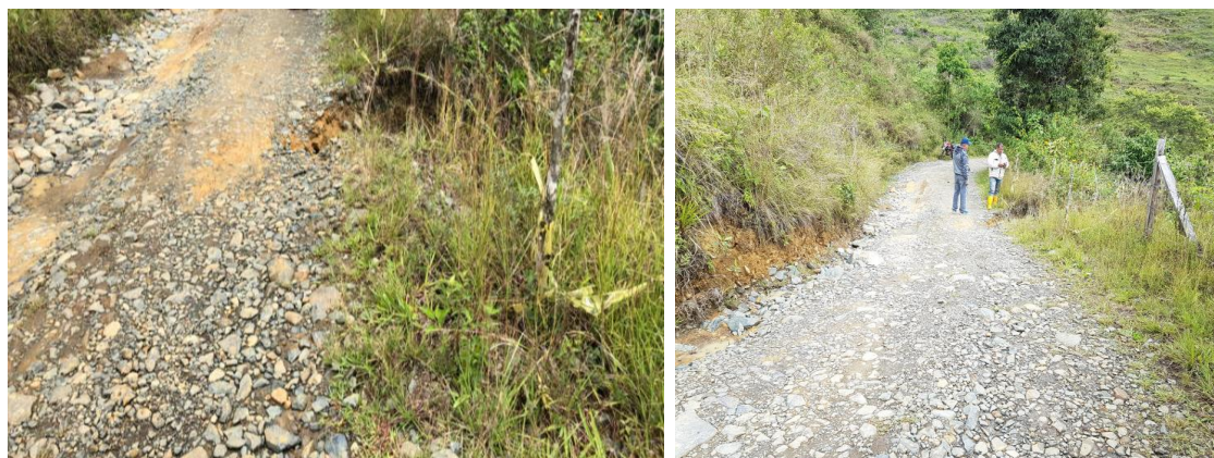
Ilustración 3. Estado inicial de la vía la Zapata - Moneterrey.
