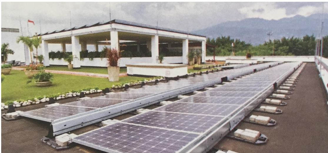
FOTO25. Páneos solares en Edificio EPSA (Cortesía de EPSA)
