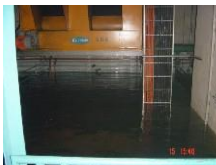
FOTO 19. Inundación Planta Alto Anchicayá (Cortesía de EPSA)
