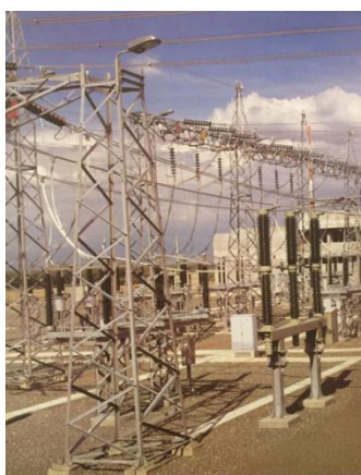
FOTO14. Subestación San Marcos (Cortesía de EPSA)
