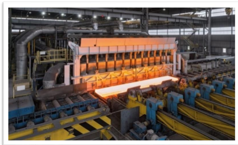
Figura 30. Hornos de de vigas caminantes para calentamiento de palanquilla:
