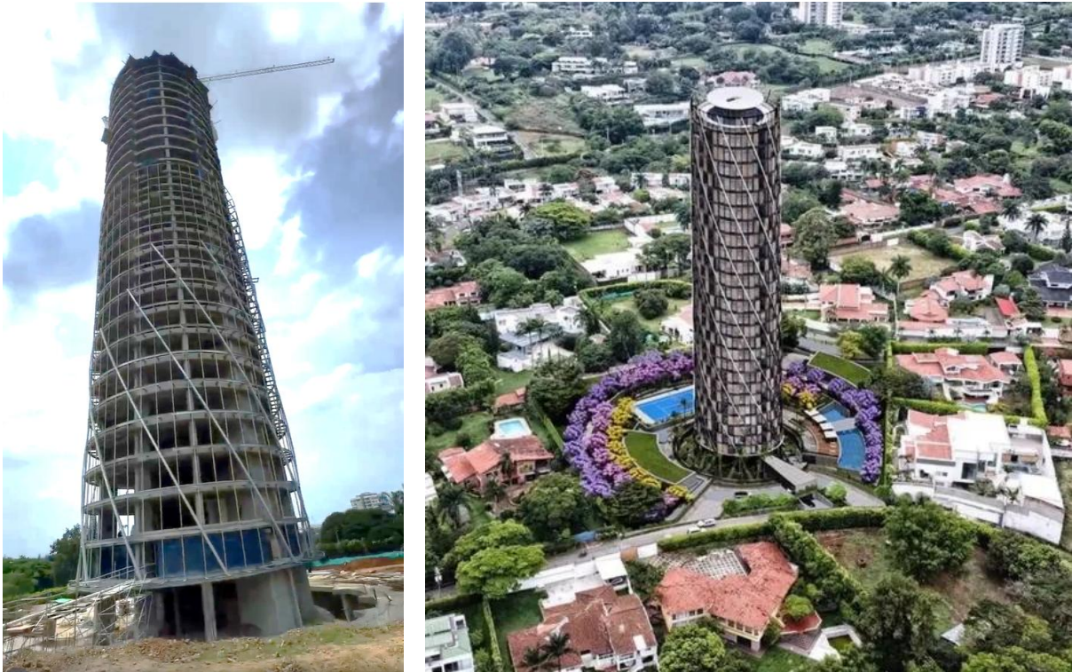
Figura 26. Proyecto Torre Jardines de Babilonia en el Distrito Especial de Santiago de Cali. Fuente: (Delta Arquitectura, 2025)
