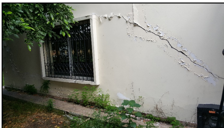
Figura 2.1 Falla por contracto expansión en vivienda
