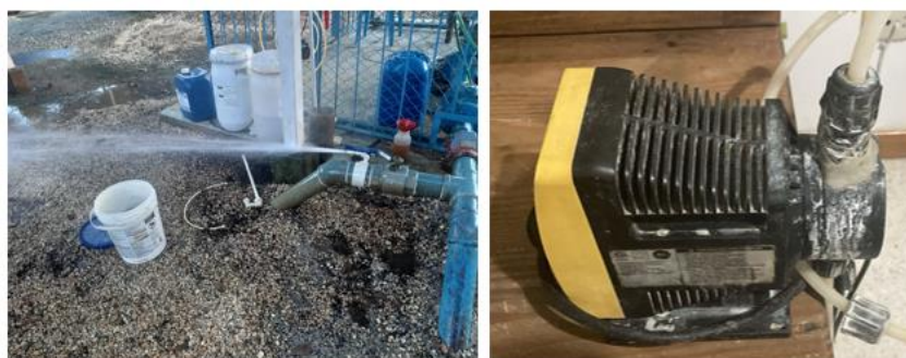
Figura 28. Problemas en la aplicación del cloruro férrico en la PTAP.
