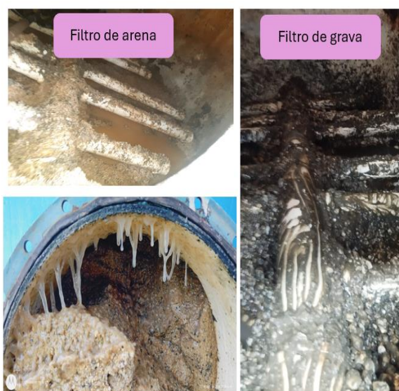
Figura 16. Estado interno del filtro de arena y grava sedimentos gelatinosos.
