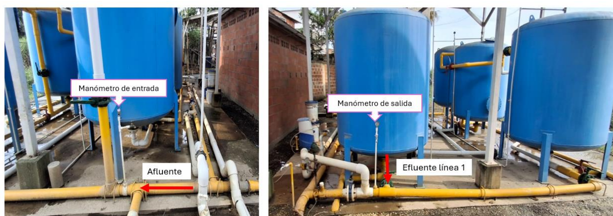
Figura 4. Ubicación de manómetros para medir pérdidas de energía en la PTAP.
