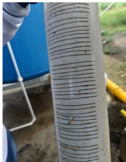
Figura 17. Manifold de lavado de los filtros, con ranuras obstruidas.
