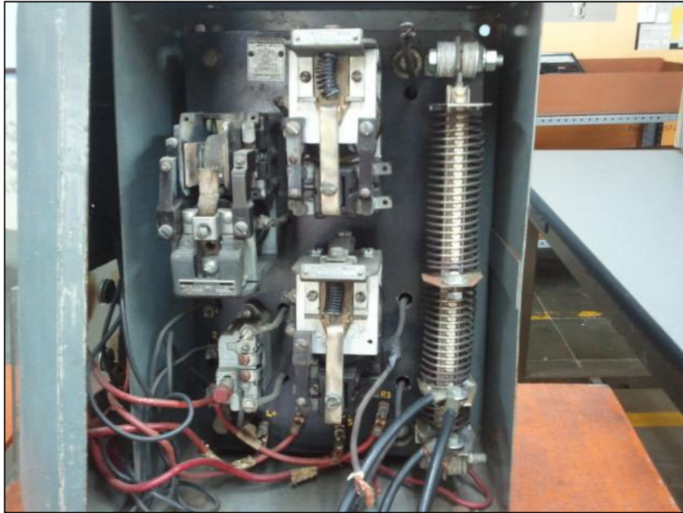
Figura 26. Resistencia limitadora de corriente con disposición de tap's
