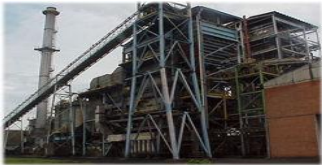
Figura 7. Caldera de Recuperación 16
