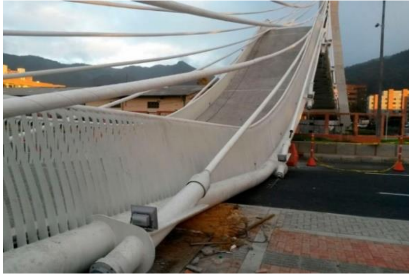
Figura 1. Colapso de puente peatonal al norte de Bogotá, Colombia (El Espectador, recuperado de: http://www.elespectador.com/noticias/bogota/puente-caido-contrato-avaluaron-dos-subtenientes-articulo-541669 ).
