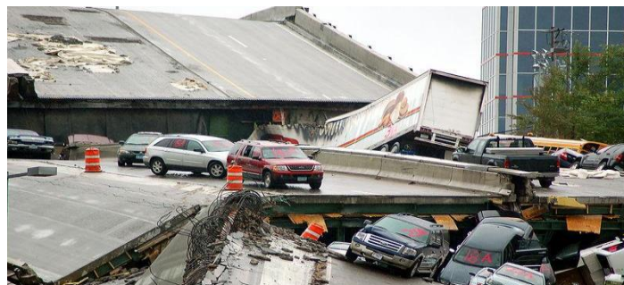
Figura 2. Puente I-35W del río Mississippi, cuatro días después del colapso (Civil Engineering, recuperado de: https://twitter.com/engineeringcivi/status/561497739658534913 ).
