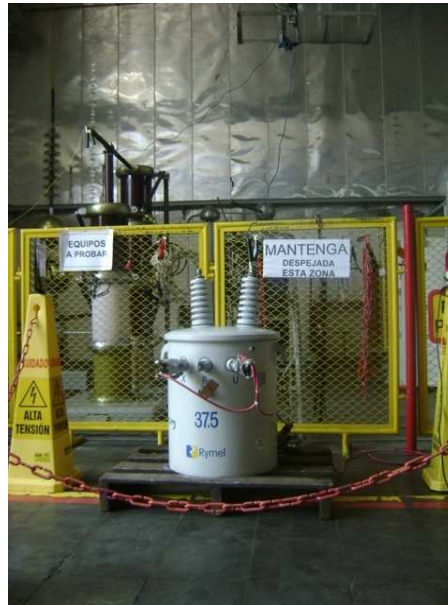
Figura 13. Montaje tensión tipo impulso en transformador.
