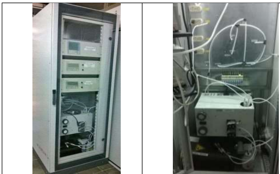
Figura 9. Sistema de acondicionamiento y análisis de gases.
