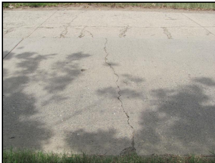
Fotografía 8.35. Grietas transversales sector K2+585 a K3+000 (Ref. 6.2.5.3)
