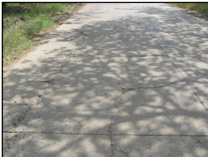
Fotografía 8.20. Grietas en bloque sector K1+000 a K1+150 (Ref. 6.2.5.5)
