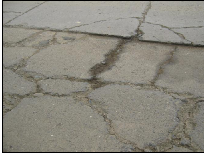
Fotografía 9.5. Infiltración de agua en juntas y grietas.
