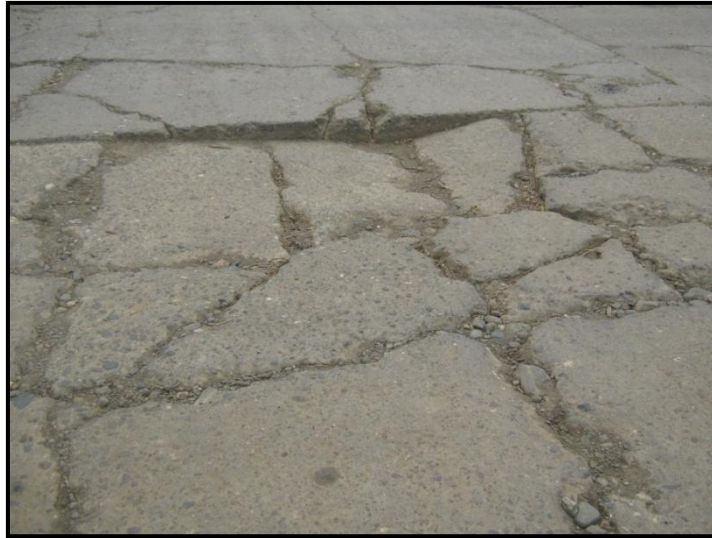
Fotografía 8.42. Hundimientos sector K4+000 a K4+789 (Ref. 6.2.5.17)
