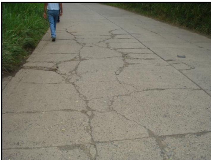
Fotografía 8.10. Grietas en bloque sector K0+650 a K0+723 (Ref. 6.2.5.5)
