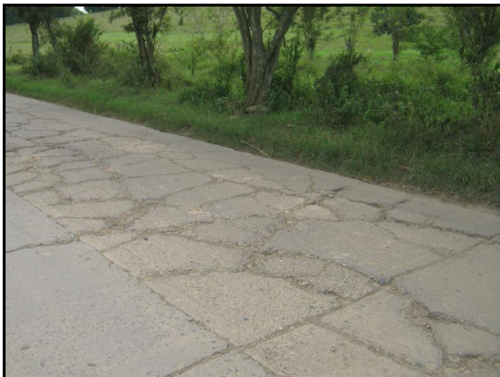
Fotografía 8.50. Grietas en bloque sector K4+815 a K4+899 (Ref. 6.2.5.5)
