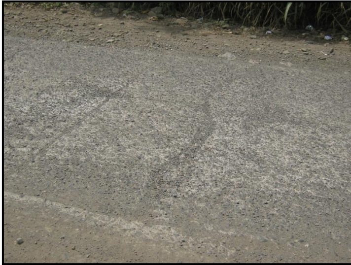
Fotografía 8.37. Grietas transversales sector K3+000 a K3+150 (Ref. 6.2.5.3)
