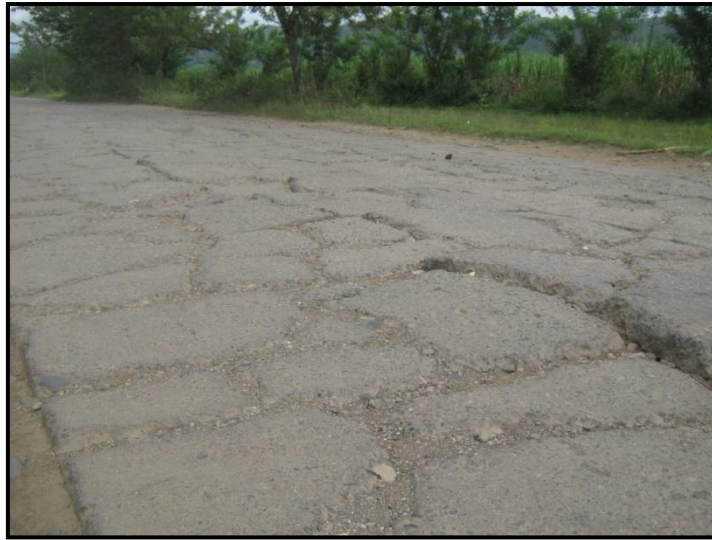
Fotografía 8.53. Presencia de humedad en grietas K4+850 (Ref. 6.2.5.5)
