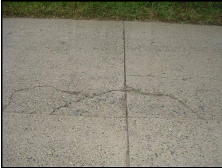
Fotografía 8.12. Grietas de esquina sector K0+650 a K0+723 (Ref. 6.2.5.1)
