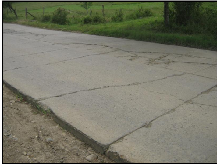
Fotografía 8.49. Grieta transversal sector K4+815 a K4+899 (Ref. 6.2.5.3)
