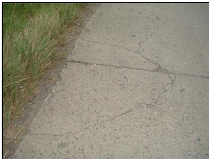
Fotografía 8.8. Grietas de esquina sector K0+500 a K0+650 (Ref. 6.2.5.1)
