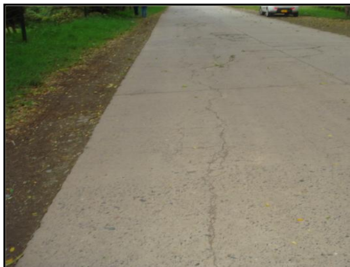
Fotografía 8.3. Grietas longitudinales sector K0+000 a K0+286 (Ref. 6.2.5.2)
