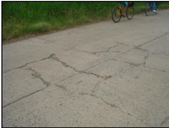
Fotografía 8.14. Grietas en bloque sector K0+723 a K0+921 (Ref. 6.2.5.5)
