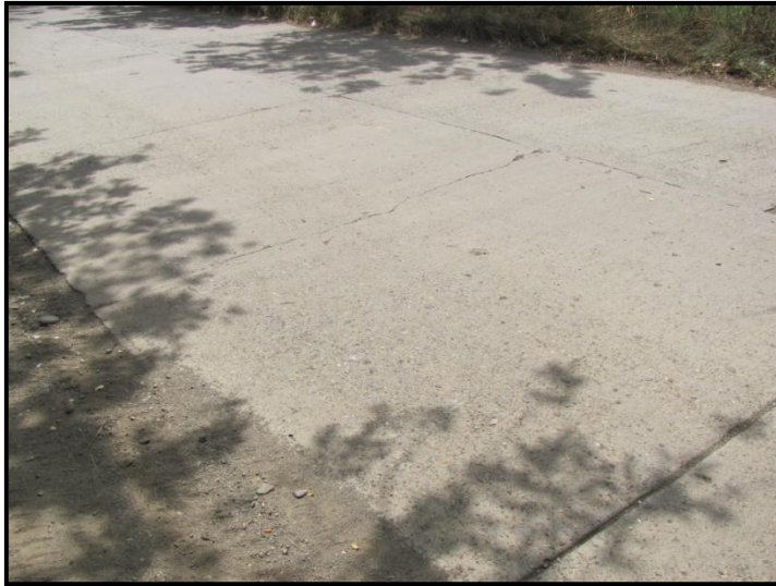
Fotografía 8.22. Grietas transversales sector K1+150 a K1+300 (Ref. 6.2.5.3)
