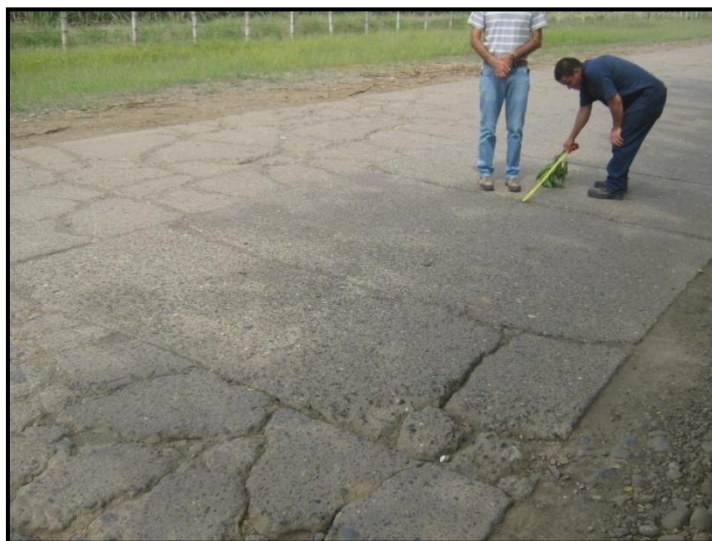
Fotografía 8.55. Grieta transversal sector K4+939 a K5+000 (Ref. 6.2.5.3)
