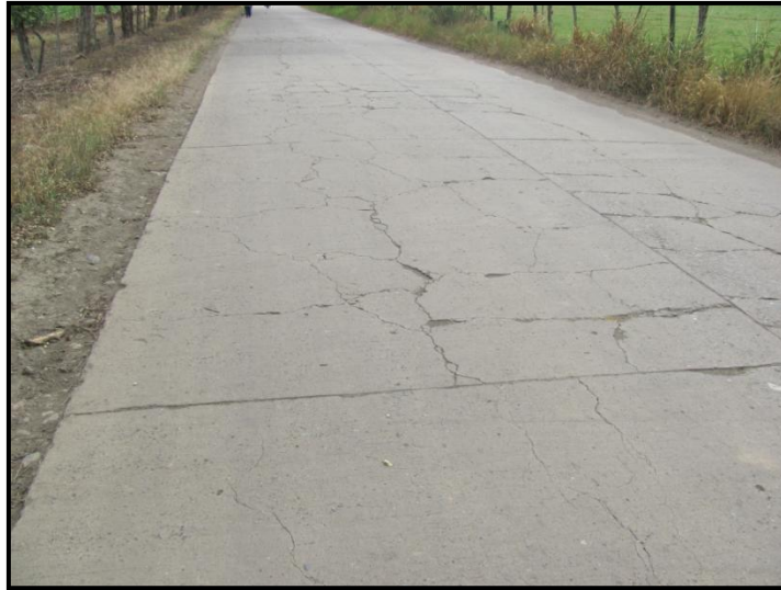
Fotografía 8.25. Grietas en bloque sector K1+300 a K1+620 (Ref. 6.2.5.5)
