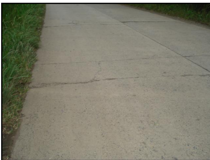
Fotografía 8.11. Grietas transversales sector K0+650 a K0+723 (Ref. 6.2.5.3)
