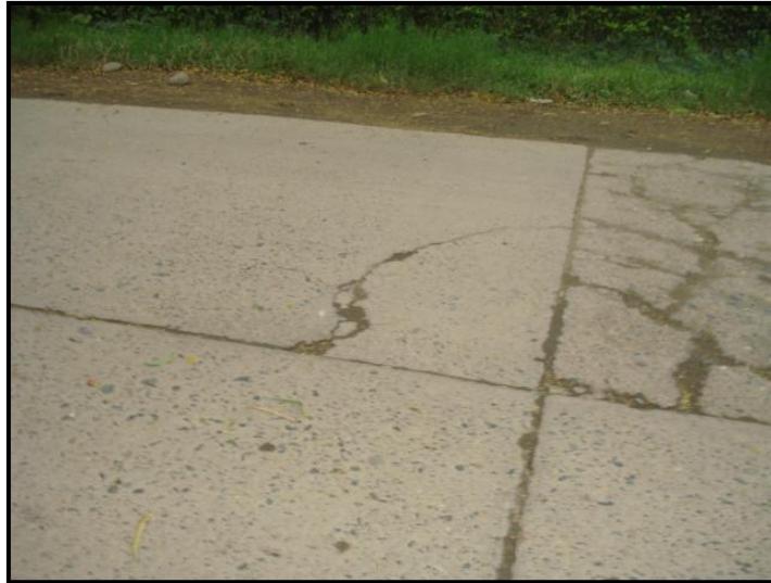
Fotografía 8.2. Grietas de esquina sector K0+000 a K0+286 (Ref. 6.2.5.1)
