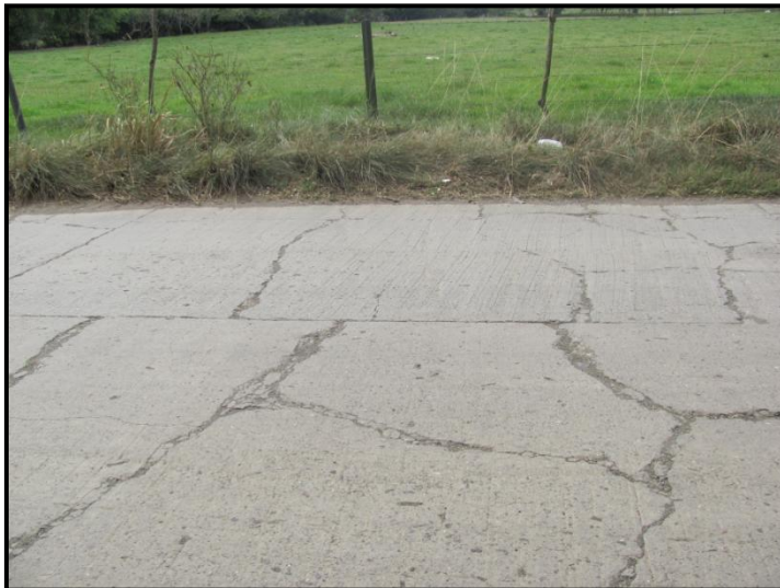
Fotografía 8.26. Grietas transversales sector K1+300 a K1+620 (Ref. 6.2.5.3)
