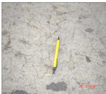
Fotografía 5. Fisuración por retracción típica con nivel de severidad bajo
