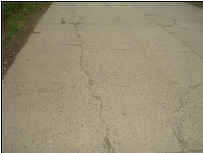
Fotografía 8.19. Grietas longitudinales sector K0+921 a K1+000 (Ref. 6.2.5.2)
