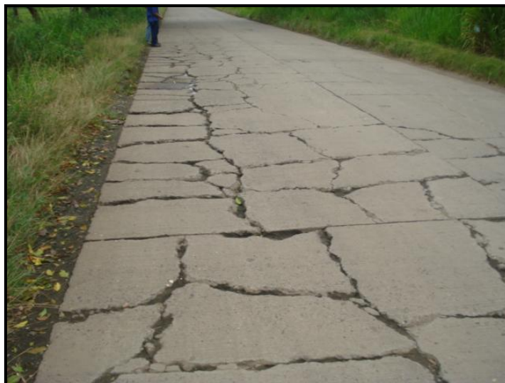
Fotografía 8.4. Grietas en bloque sector K0+286 a K0+500 (Ref. 6.2.5.5)
