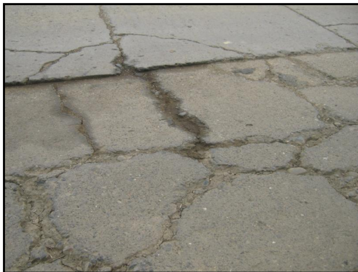
Fotografía 8.52. Presencia de humedad en grietas K4+850
