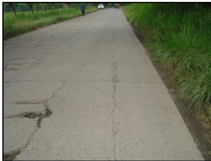
Fotografía 8.6. Grietas longitudinales sector K0+286 a K0+500 (Ref. 6.2.5.2)
