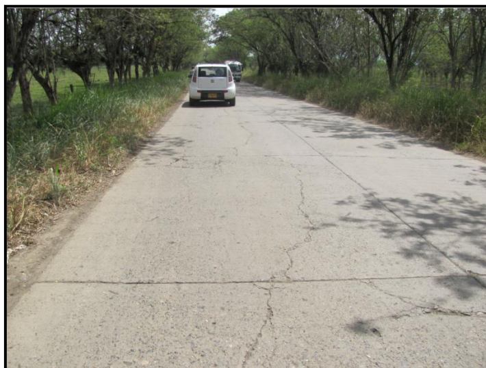
Fotografía 8.24. Grietas longitudinales K1+150 a K1+300 (Ref. 6.2.5.2)
