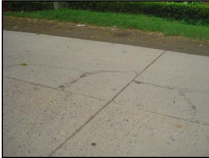
Fotografía 8.15. Grietas de esquina sector K0+723 a K0+921 (Ref. 6.2.5.1)
