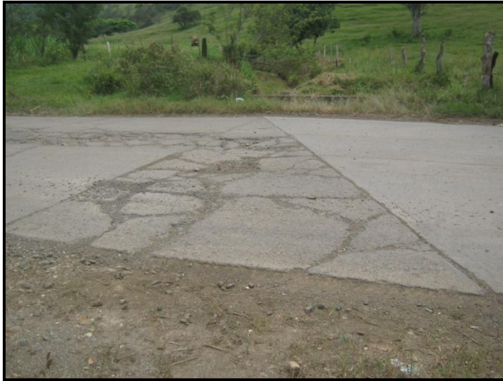
Fotografía 8.47. Grietas en bloque sector K4+806 a K4+815 (Ref. 6.2.5.5)
