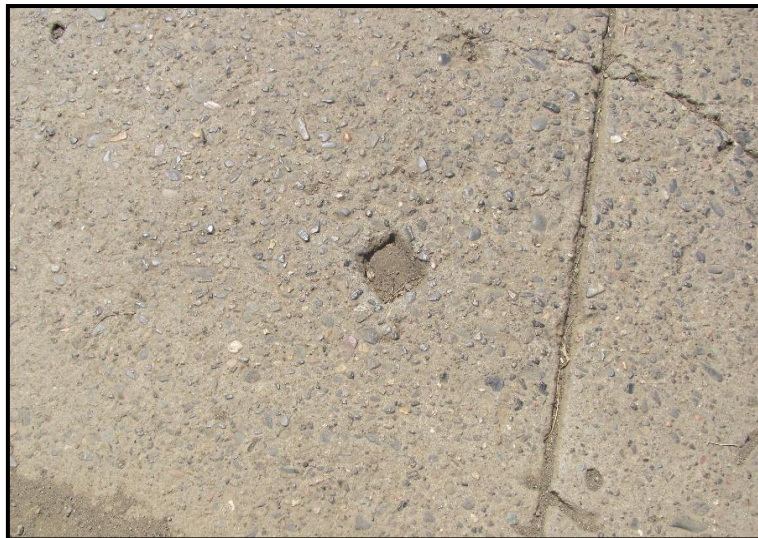
Fotografía 9.3. Ausencia de sello en juntas
