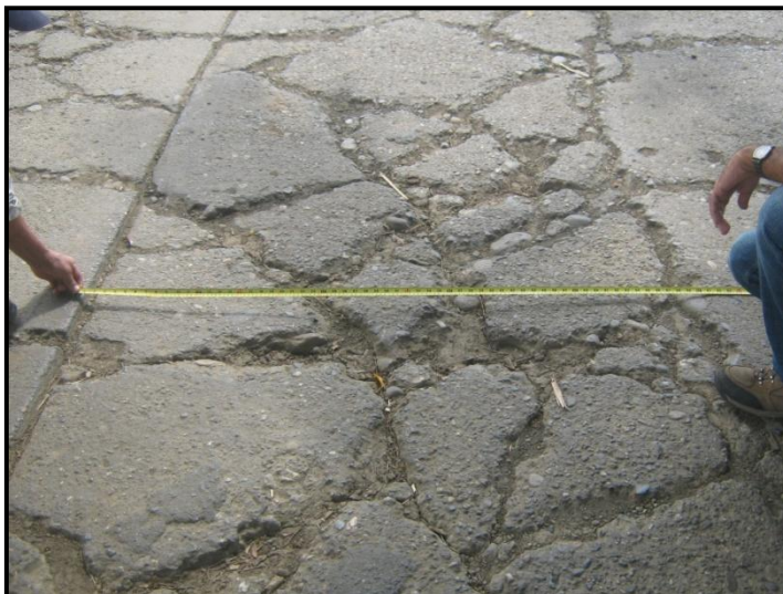
Fotografía 8.39. Hundimientos sector K3+150 a K4+000 (Ref. 6.2.5.17)
