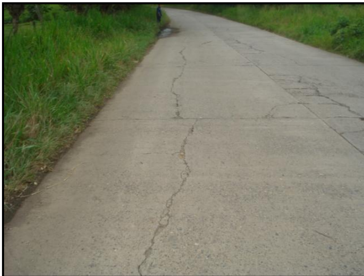
Fotografía 8.13. Grietas longitudinales sector K0+650 a K0+723 (Ref. 6.2.5.2)
