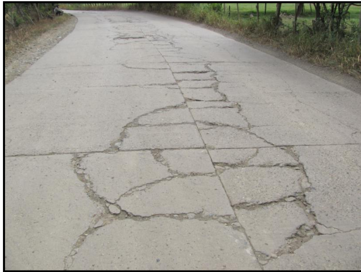
Fotografía 8.27. Grietas en bloque sector K1+620 a K1+775 (Ref. 6.2.5.5)
