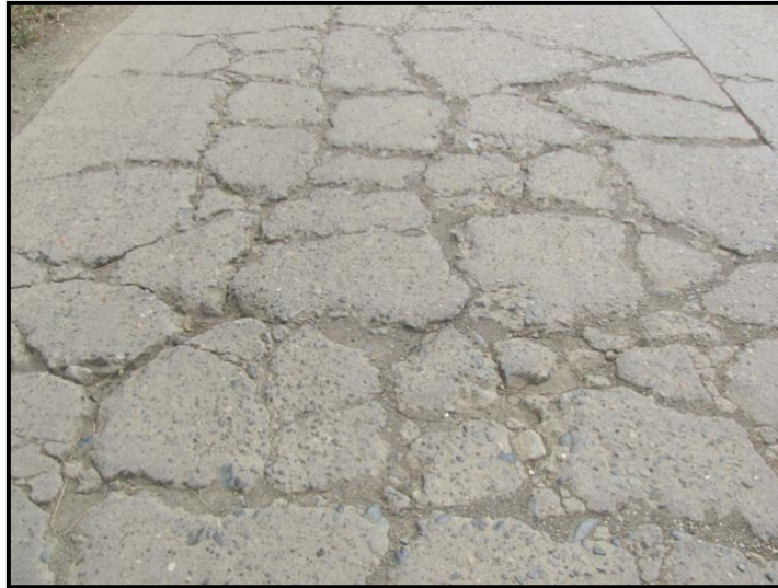
Fotografía 8.46. Grietas en bloque sector K4+789 a K4+806 (Ref. 6.2.5.5)
