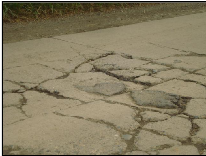
Fotografía 8.17. Grietas en bloque sector K0+921 a K1+000 (Ref. 6.2.5.5)
