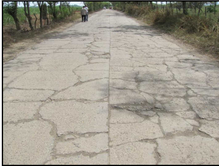
Fotografía 8.33. Grietas en bloque sector K2+282 a K2+585 (Ref. 6.2.5.5)
