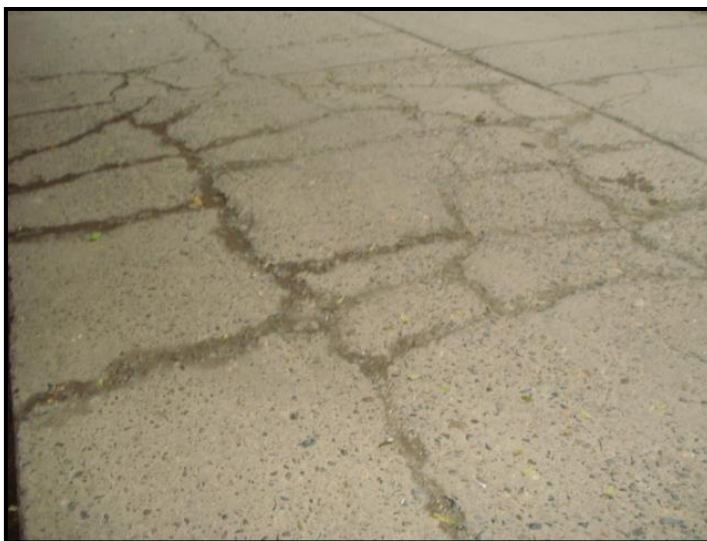
Fotografía 8.1. Grietas en bloque sector K0+000 a K0+286 (Ref. 6.2.5.5)
