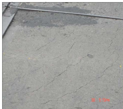
Fotografía 6. Vista típica de fisuras ligeras de aparición temprana
