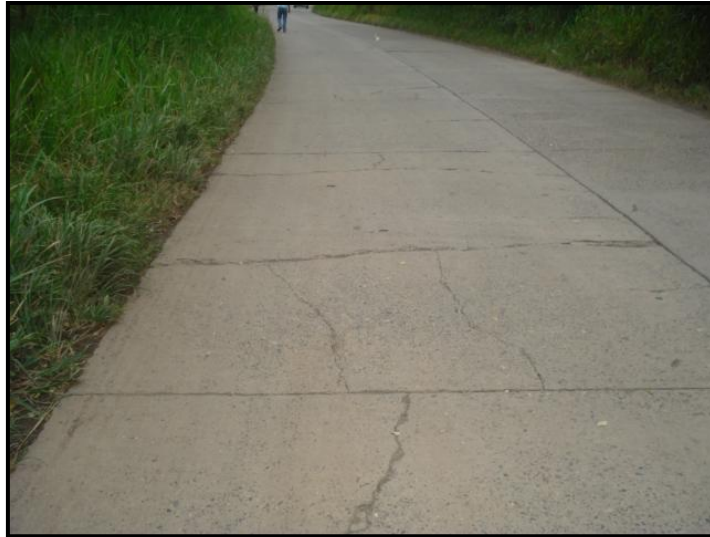
Fotografía 8.7. Grietas transversales sector K0+500 a K0+650 (Ref. 6.2.5.3)
