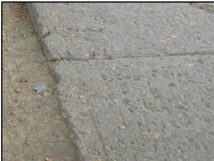
Fotografía 8.45. Desintegración sector K4+000 a K4+789 (Ref. 6.2.5.11)
