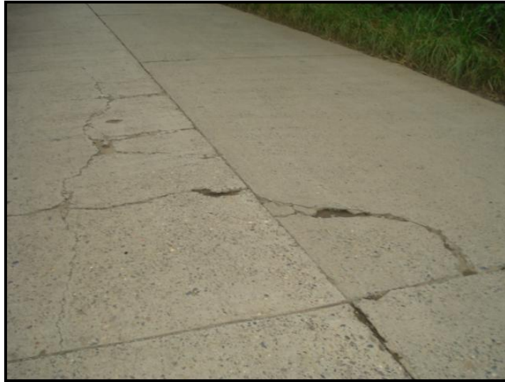
Fotografía 8.5. Grietas de esquina sector K0+286 a K0+500 (Ref. 6.2.5.1)
