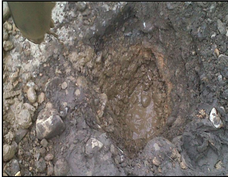
Fotografía 9.2. Problemas de drenaje de aguas freáticas
