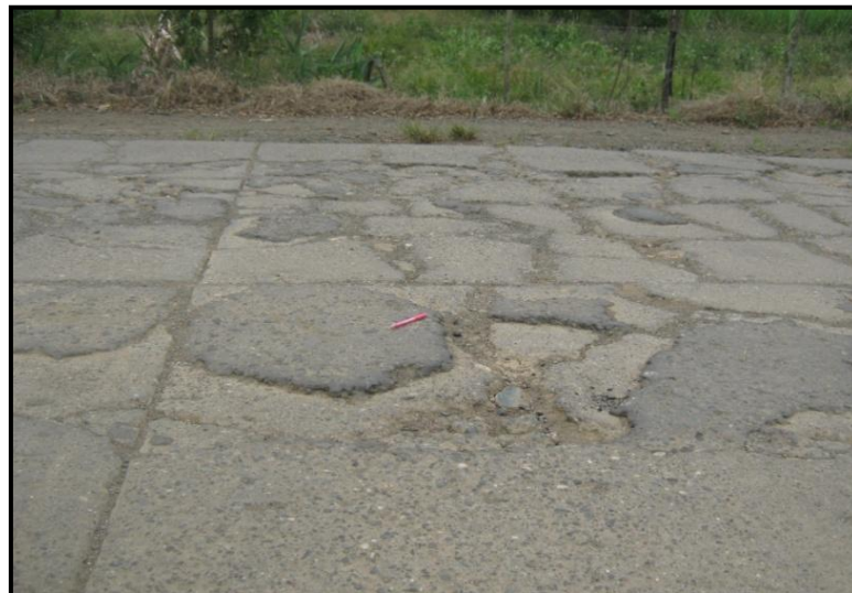
Fotografía 8.43. Rastros de sobrecarpeta asfáltica sector K4+000 a K4+789
