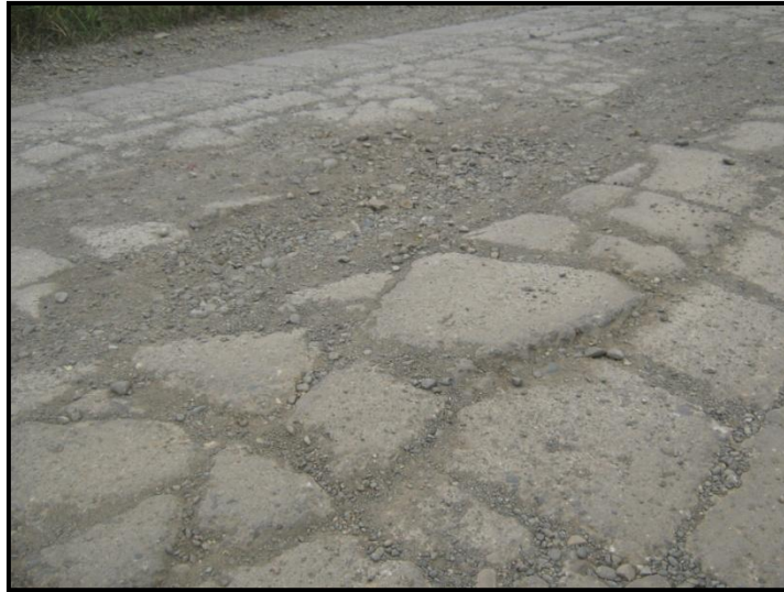
Fotografía 8.44. Baches sector K4+000 a K4+789 (Ref. 6.2.5.12)
