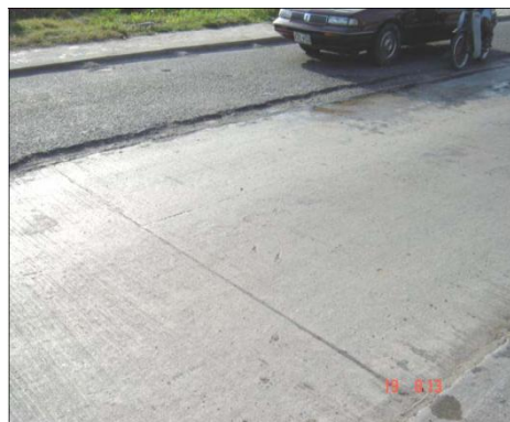
Fotografía 2. Vista típica de una vía con pulimiento de losas de concreto
