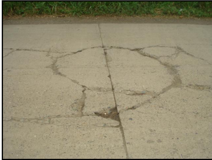
Fotografía 8.18. Grietas de esquina sector K0+921 a K1+000 (Ref. 6.2.5.1)
