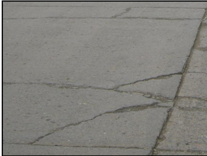
Fotografía 8.51. Grietas de esquina sector K4+815 a K4+899 (Ref. 6.2.5.1)
