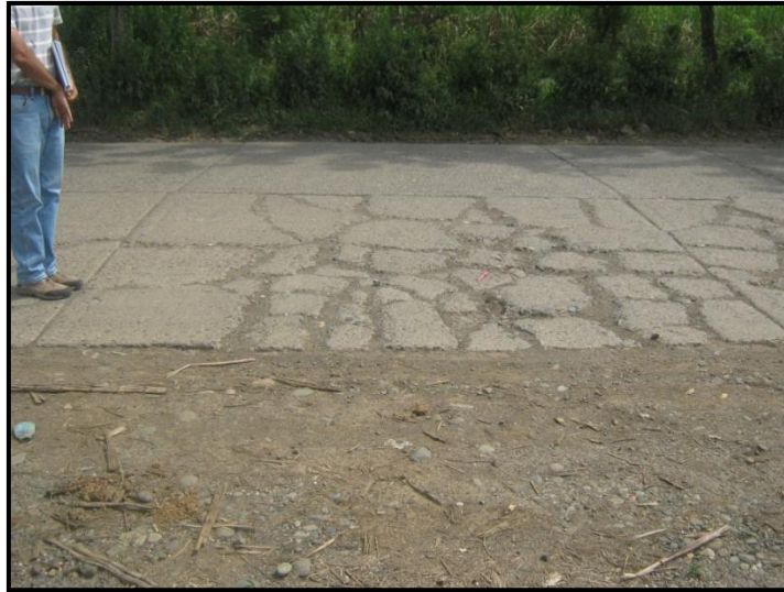
Fotografía 8.54. Grietas en bloque sector K4+939 a K5+000 (Ref. 6.2.5.5)
