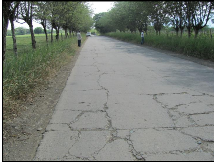
Fotografía 8.21. Grietas longitudinales sector K1+000 a K1+150 (Ref. 6.2.5.2)
