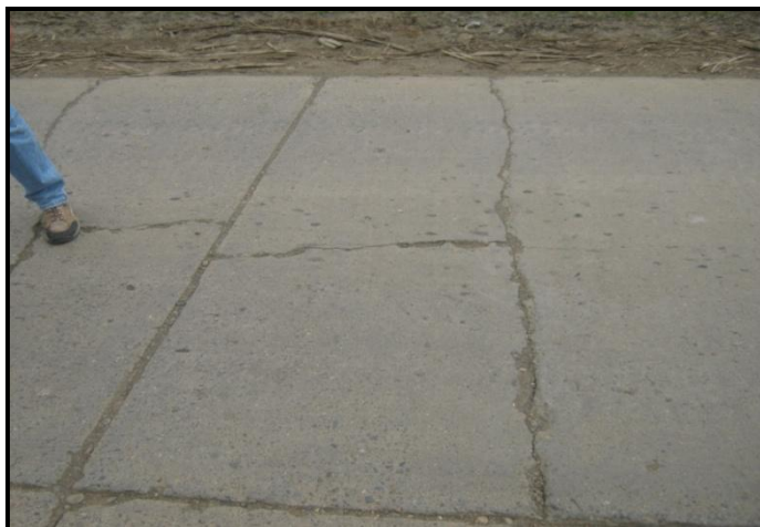
Fotografía 8.48. Grieta longitudinal sector K4+815 a K4+899 (Ref. 6.2.5.2)
