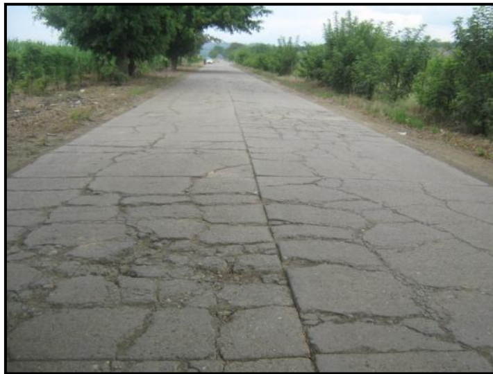
Fotografía 9.1. Ausencia de estructuras de drenaje de aguas superficiales
