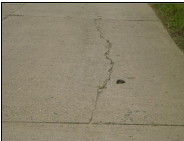
Fotografía 8.9. Grietas longitudinales sector K0+500 a K0+650 (Ref. 6.2.5.2)
