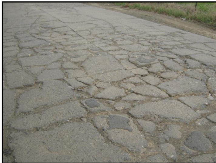
Fotografía 8.41. Grietas en bloque sector K4+000 a K4+789 (Ref. 6.2.5.5)
