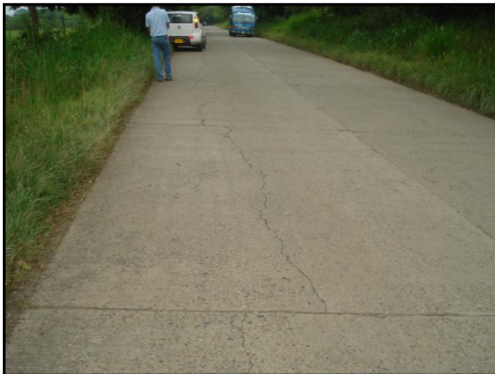
Fotografía 8.16. Grietas longitudinales sector K0+723 a K0+921 (Ref. 6.2.5.2)
