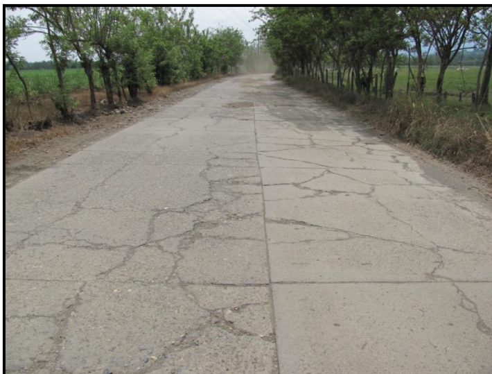
Fotografía 8.29. Grietas en bloque sector K1+775 a K2+000 (Ref. 6.2.5.5)
