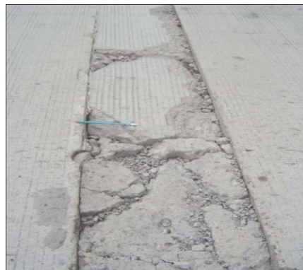
Fotografía 3. Parche en concreto
