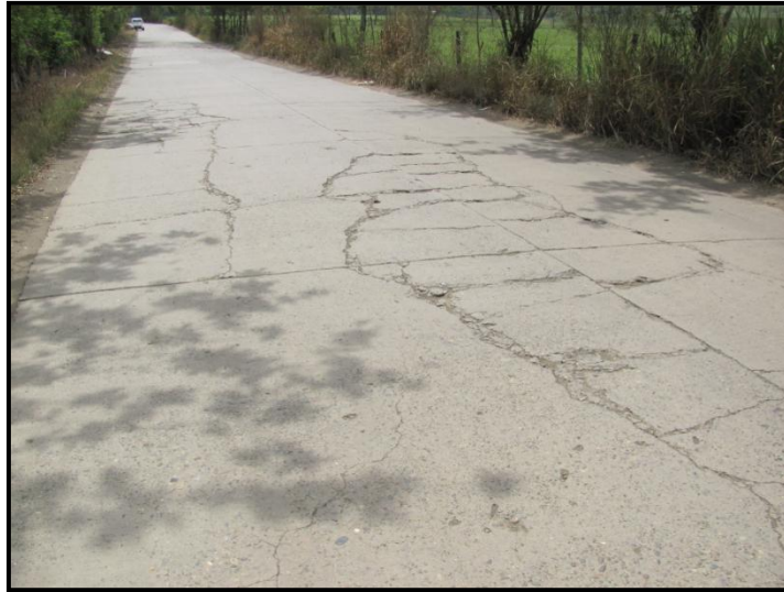
Fotografía 8.28. Grietas longitudinales sector K1+620 a K1+775 (Ref. 6.2.5.2)
