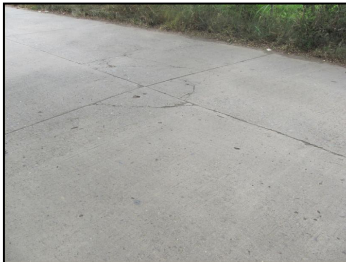
Fotografía 8.23. Grietas de esquina K1+150 a K1+300 (Ref. 6.2.5.1)
