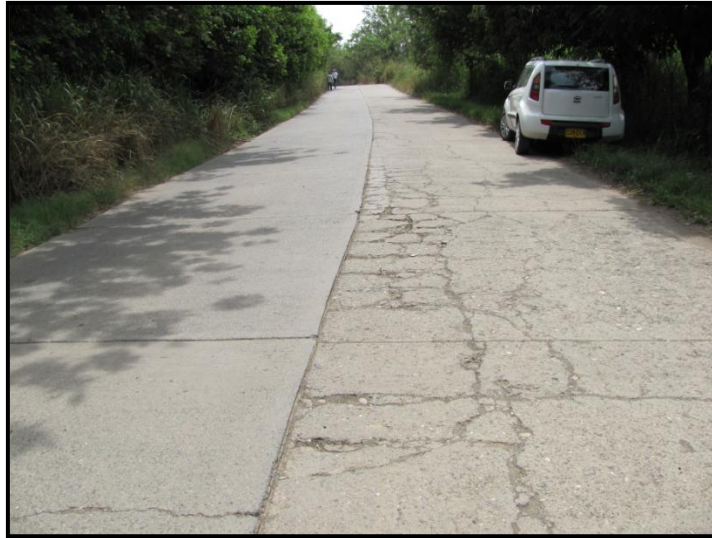
Fotografía 8.34. Grietas en bloque sector K2+585 a K3+000 (Ref. 6.2.5.5)
