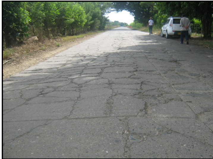
Fotografía 8.36. Grietas en bloque sector K3+000 a K3+150 (Ref. 6.2.5.5)
