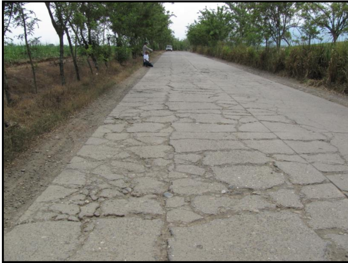
Fotografía 8.30. Grietas en bloque sector K2+000 a K2+245 (Ref. 6.2.5.5)
