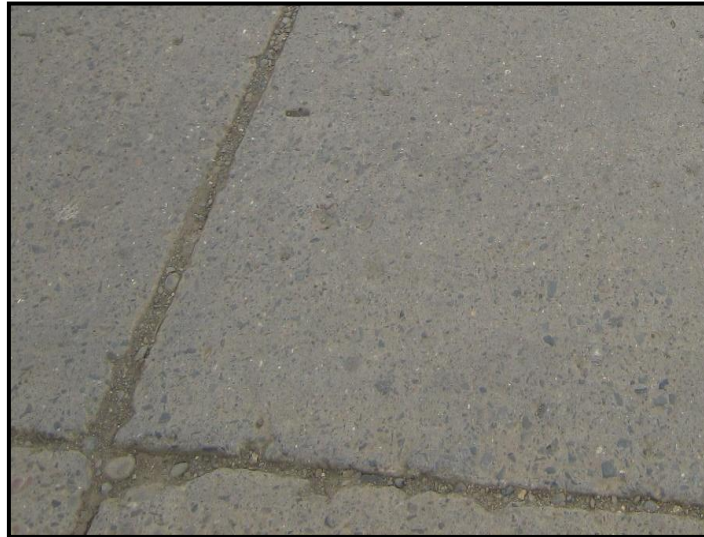
Fotografía 8.56. Deterioro del sello (Ref. 6.2.5.8)
