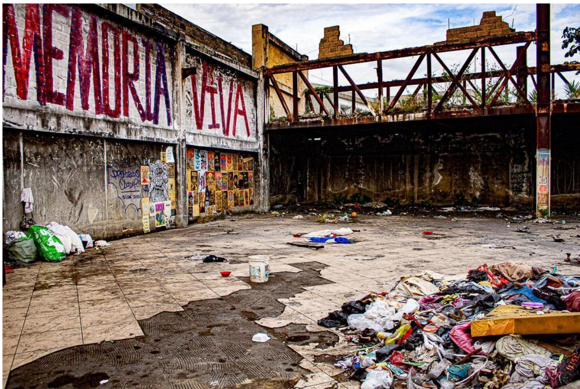
Parte interna del Dollarcity, se puede ver las vigas muy afectadas por el incendio
