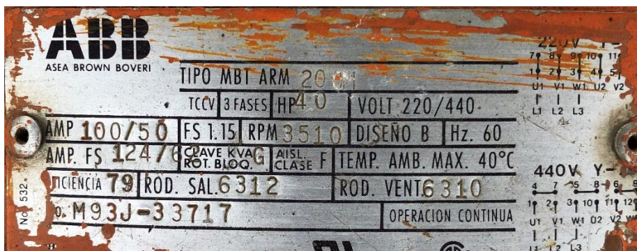
Figura 75. Placa característica bomba de lavado desarenadores.
