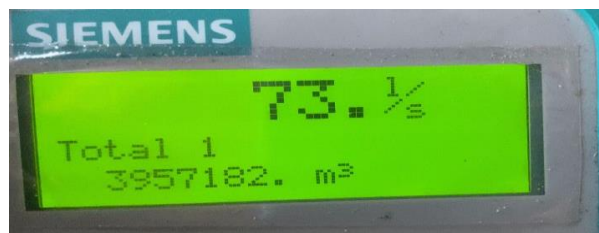
Figura 23. Caudal de salida de la bomba # 1 de la estación de bombeo Bellavista #3 de la planta Rio Cali (Elaboración propia).
