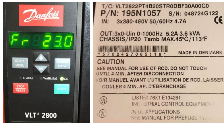
Figura 89. Placa característica variador tipo 1 de floculación.
