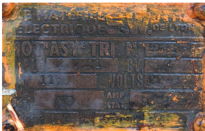
Figura 91. Placa característica motor tipo 1 de línea 3 de floculación.
