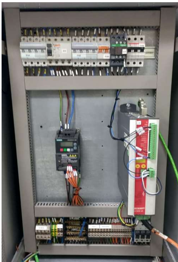
Figura 27. Tablero de Potencia. Fuente: Elaboración propia, 2025.
