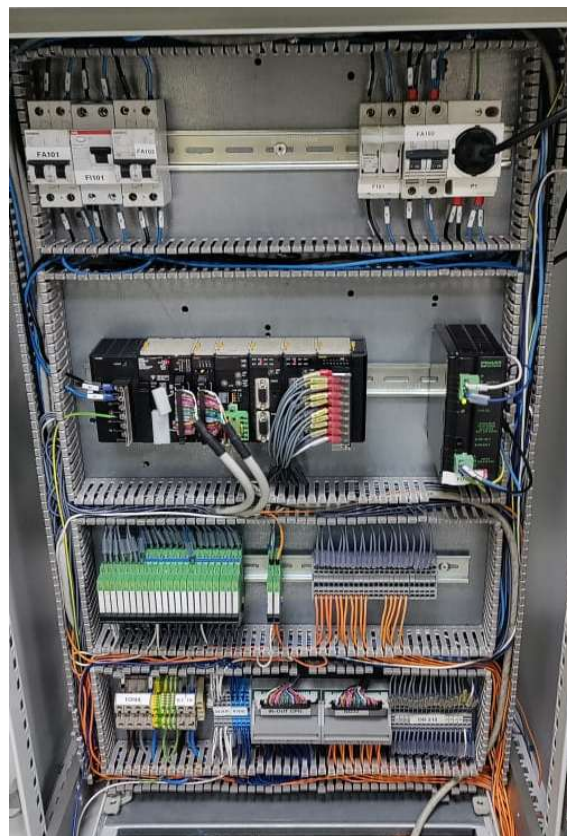
Figura 28. Tablero de Control. Fuente: Elaboración propia, 2025.
