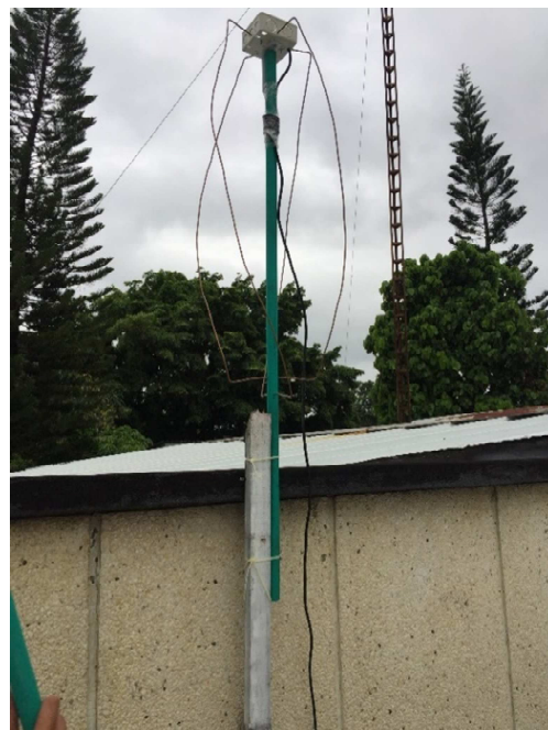
Figura 13. Antena en el Edificio E43 del campus de la Universidad del Valle.
