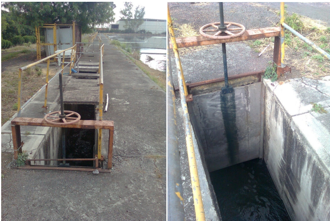
Figura 2.5. Canal de recolección de efluentes de la Laguna Facultativa
