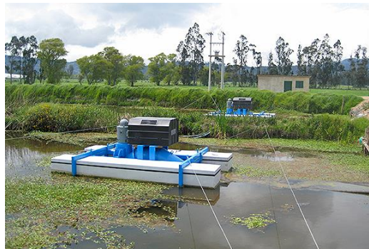
Figura 5 Equipo de bombeo flotante
