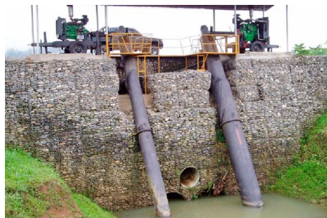
Figura 3 Equipo de Bombeo estacionario
