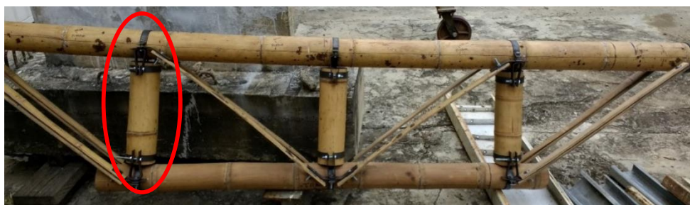
Figura 4-1 Primera cercha probada, elemento de la izquierda (resaltado en el óvalo) desviado debido al deslizamiento de la unión con la cuerda inferior.
