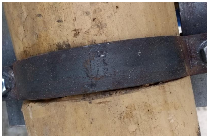
Figura 4-3 Laceración causada sobre la cuerda superior de la estructura debido al deslizamiento de la abrazadera inferior.
