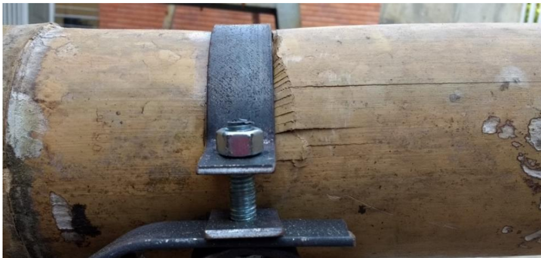
Figura 3-18 Falla de aplastamiento de la sección de la cuerda superior debido al deslizamiento del nodo inferior del elemento vertical.
