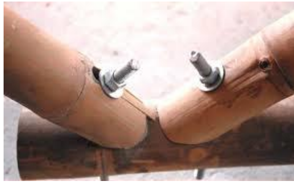
Figura 1-1 Detalle de desgarramiento en elemento de guadua causado por concentración de esfuerzos en los orificios de los pernos. (Takeuchi, 2004)
