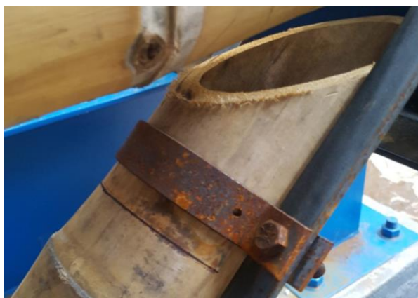
Figura 4-8 Deslizamiento de la abrazadera de la conexión de la diagonal.
