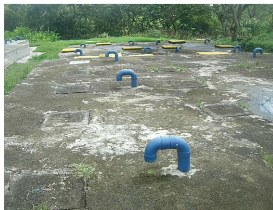
Foto 3. Tanque séptico tercer línea
