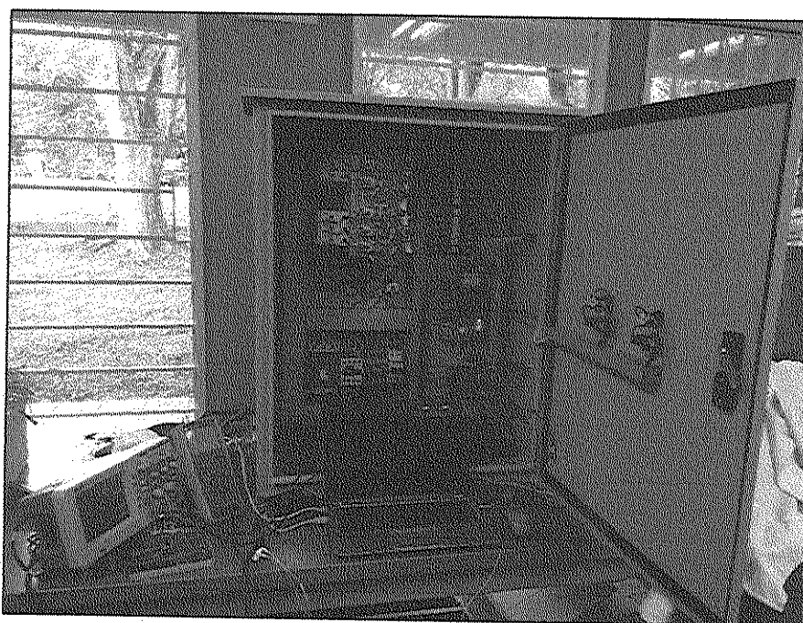
Figura 5. Pruebas y puesta en servicio del equipo LFH
