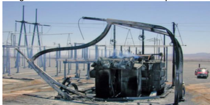
Figura 3. Falla en transformador de potencia.
