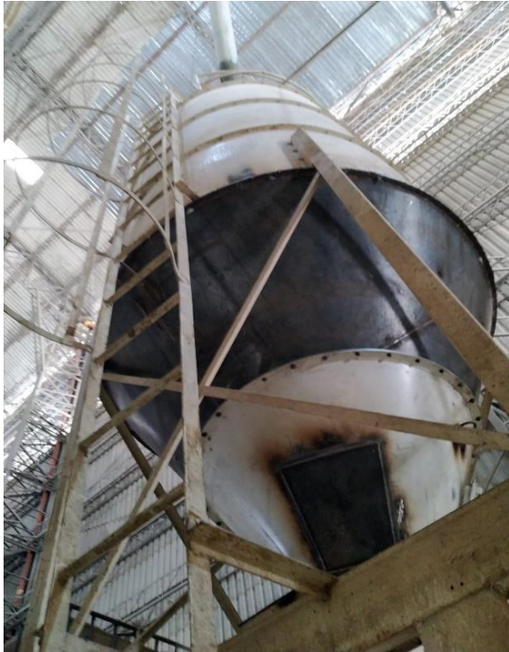
Tolva de dosificación
