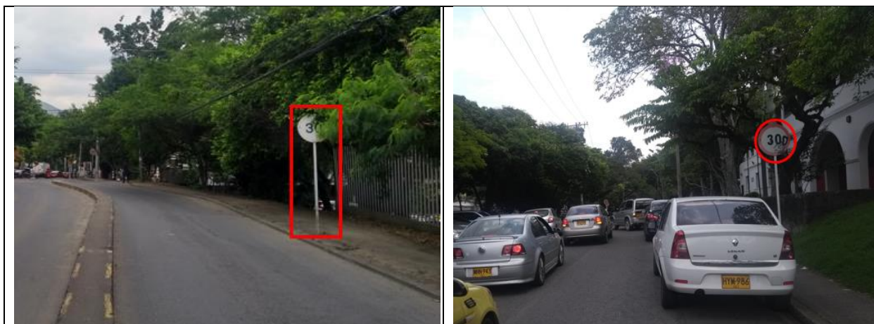
Ilustración 15. Estado de la señalización vertical.
