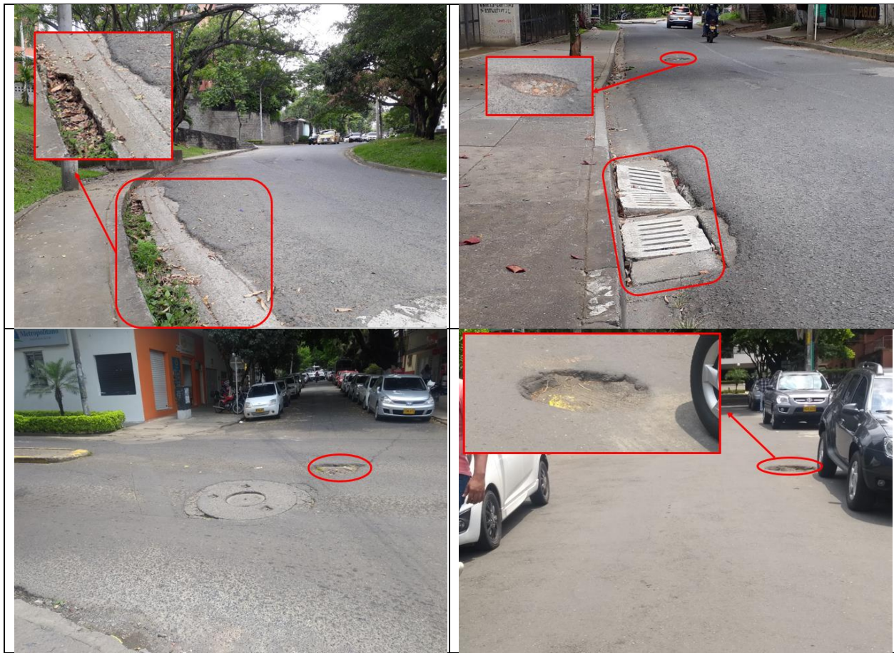
Ilustración 12. Estado de las vías.
