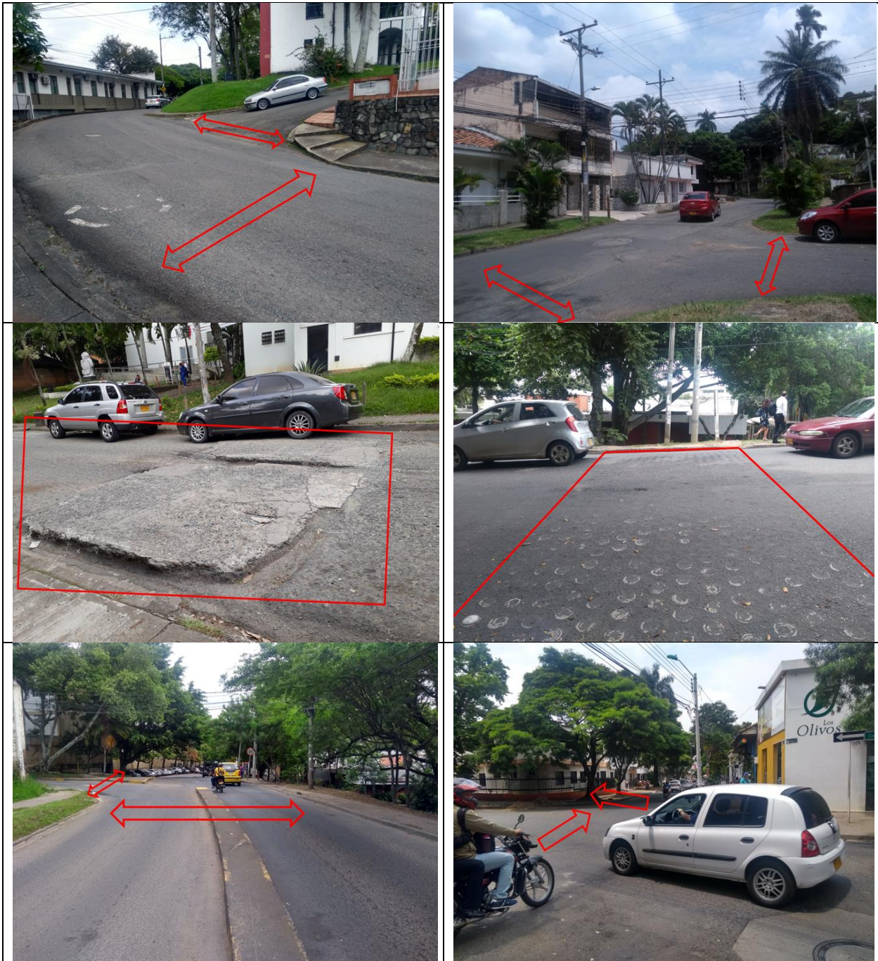
Ilustración 18. Ausencia de medidas que garanticen el paso peatonal seguro de una acera a otra. Fuente: Elaboración propia.
