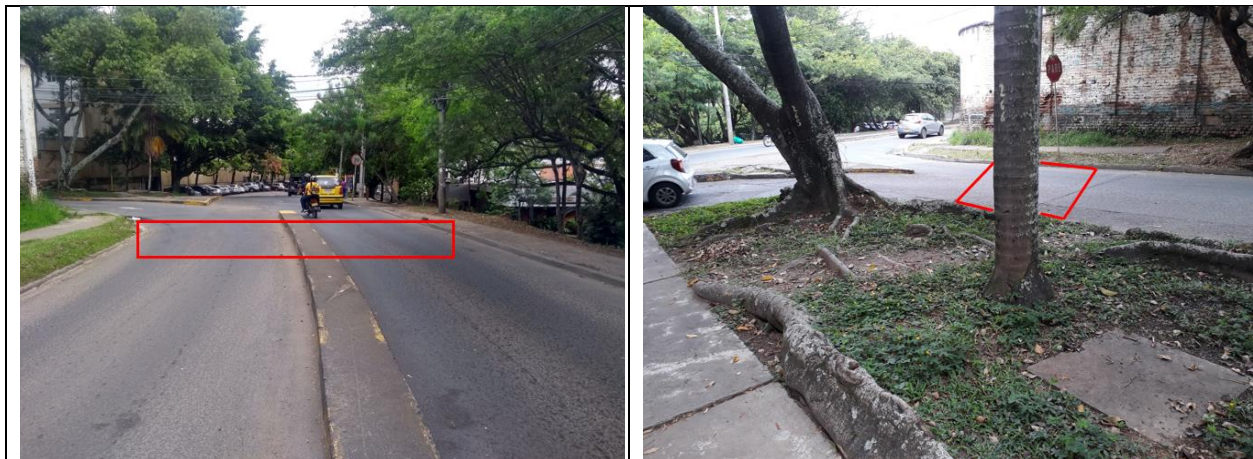
Ilustración 14. Estado de la señalización horizontal.
