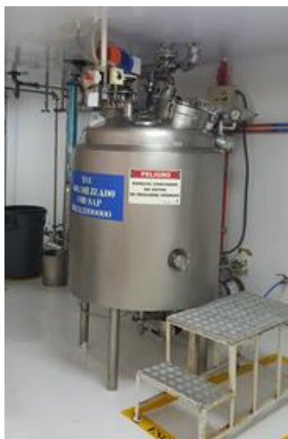
FIGURA 3 – TANQUE DE ALMACENAMIENTO
