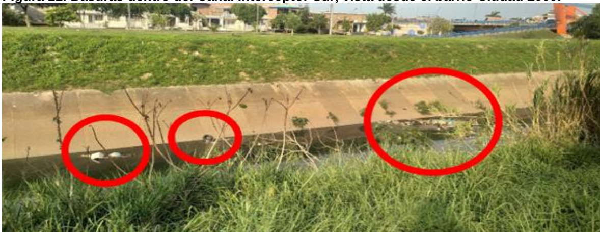
Figura 11. Basuras dentro del Canal Interceptor Sur, vista desde el barrio Ciudad 2000.
