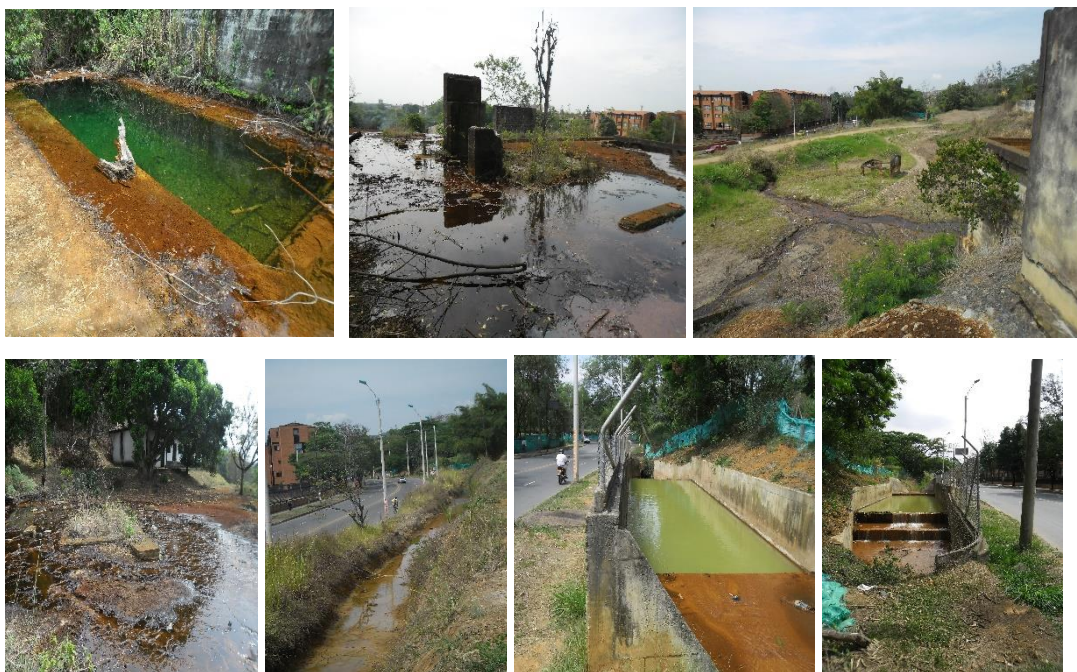
Imagen 34 a 40: Secuencia de brote de agua Box Culvert de la Avenida de los cerros con carrera 66
