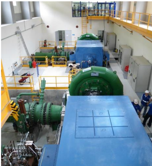
Foto 4. Turbinas Proyecto Central Hidroeléctrica Bajo Tuluá
