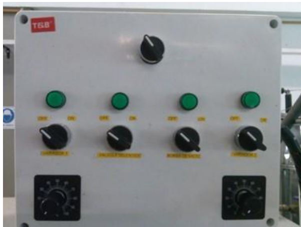
Figura 3. Control de motores, válvula solenoide y sistema de vacío del evaporador de doble efecto. Trabajo realizado en 2014 curso laboratorio de ingeniería química.
