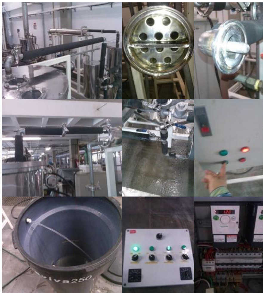
Figura 5. Soporte gráfico de mantenimiento y prueba inicial de equipos encontrados en el sistema de evaporación de doble efecto.
