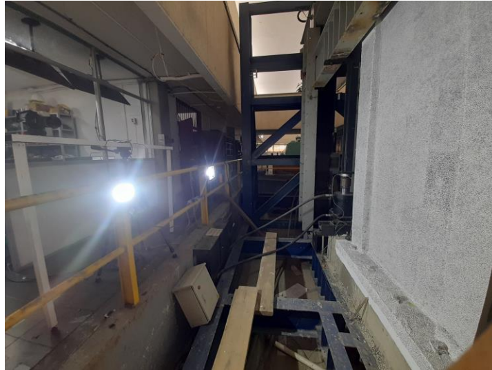
Figura 20. Sistema de iluminación compuesto por dos reflectores de 50W, configuración #1.
