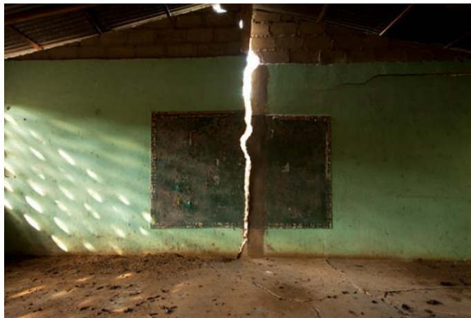
Figura 23: Silencio con grieta:
