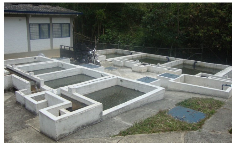
Imagen n° 1. Acueducto rural de la vereda La Vorágine.
