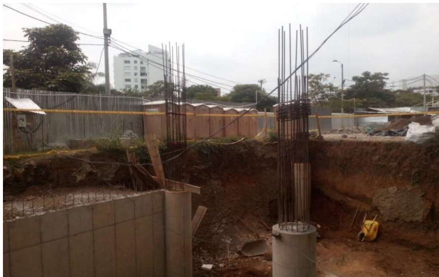
Figura 10. Riesgos en la ubicación de USP. Construcción 1
