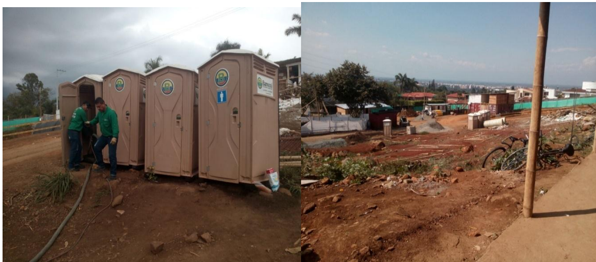
Figura 11. Dificultades de acceso a USP. Construcción 2
