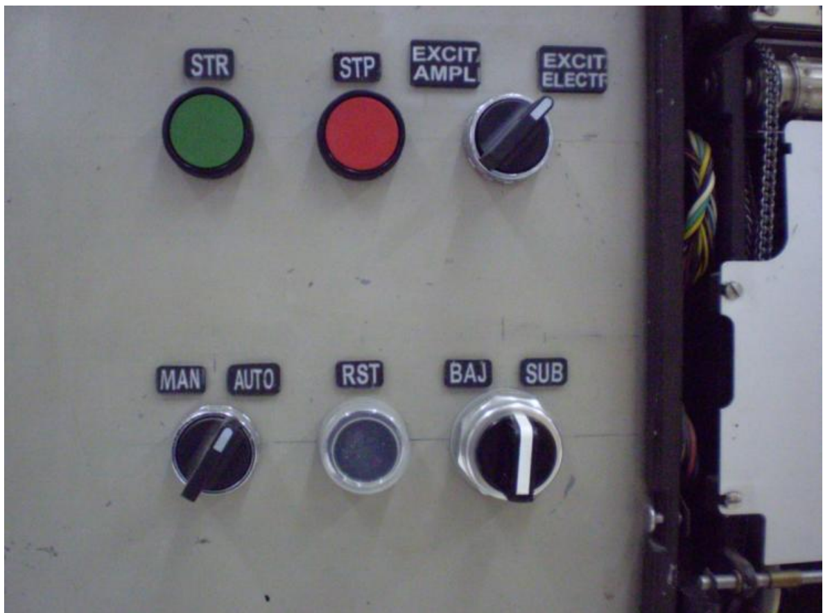
Figura 4-12. Arranque del regulador de tensión.
