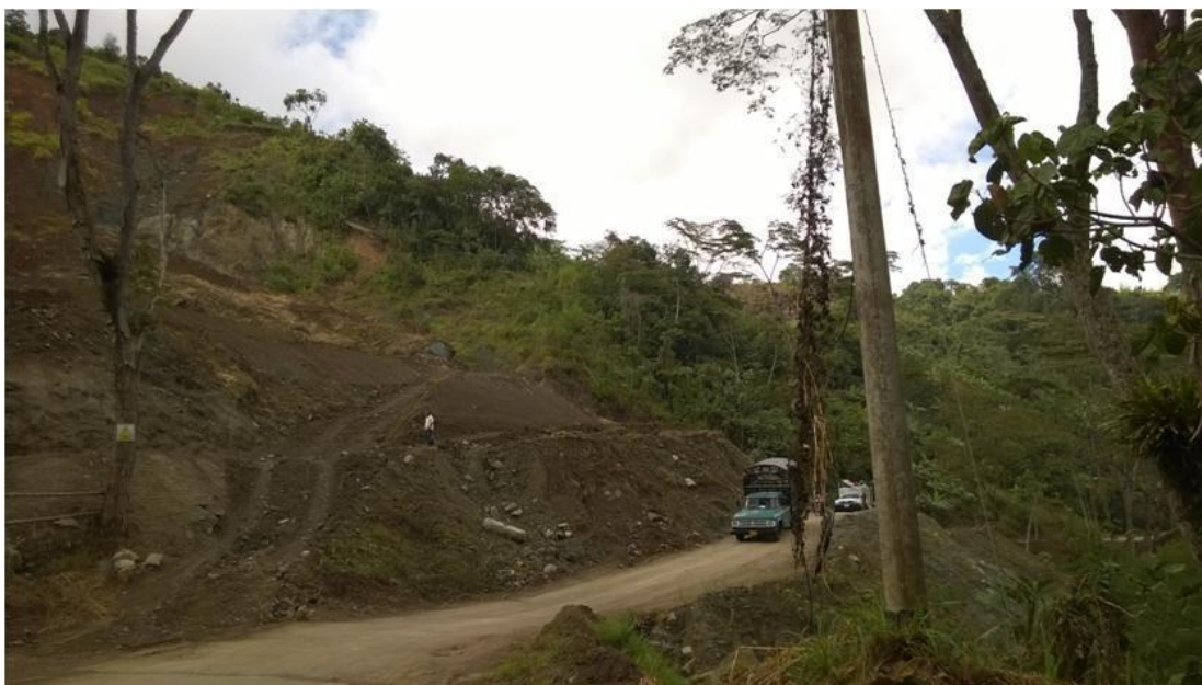
Figura 2. Estado de la vía Uribe-Sevilla intervenida para la remoción del material desprendido de la ladera. (Fuente: Geomatrix)
