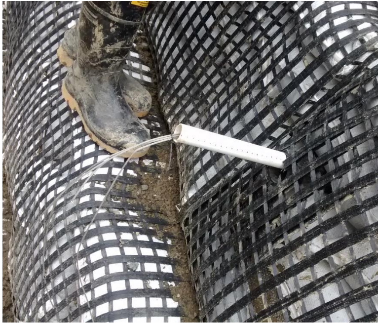
Figura 37. Instrumento N°1 instalado en el nivel 1516,25 (cara frontal del muro)
