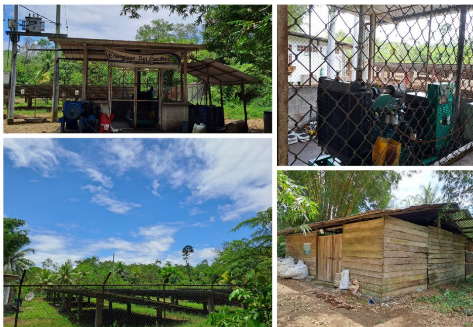
Figura 12 Planta de energía de Punta Soldado .
